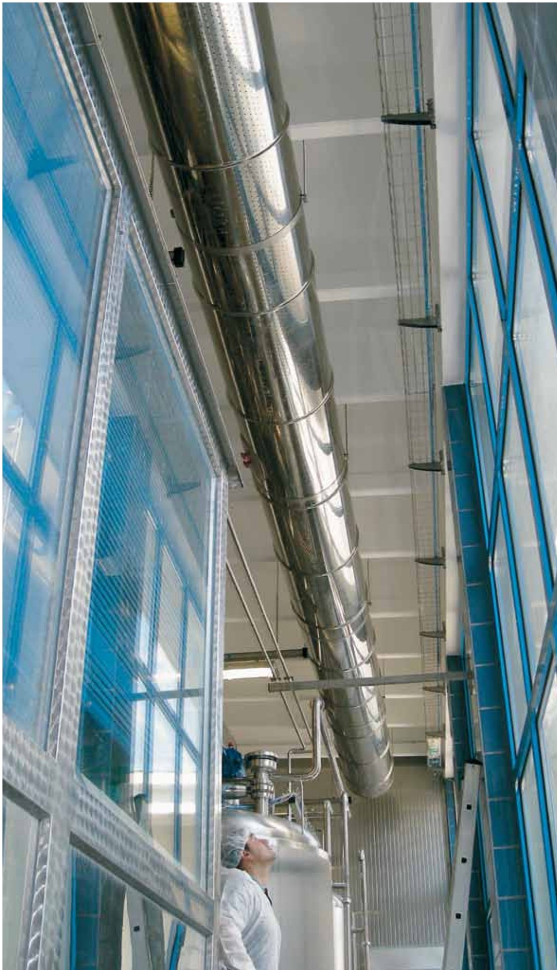
Canale circolare in metallo. Sale lavorazione alimenti.
