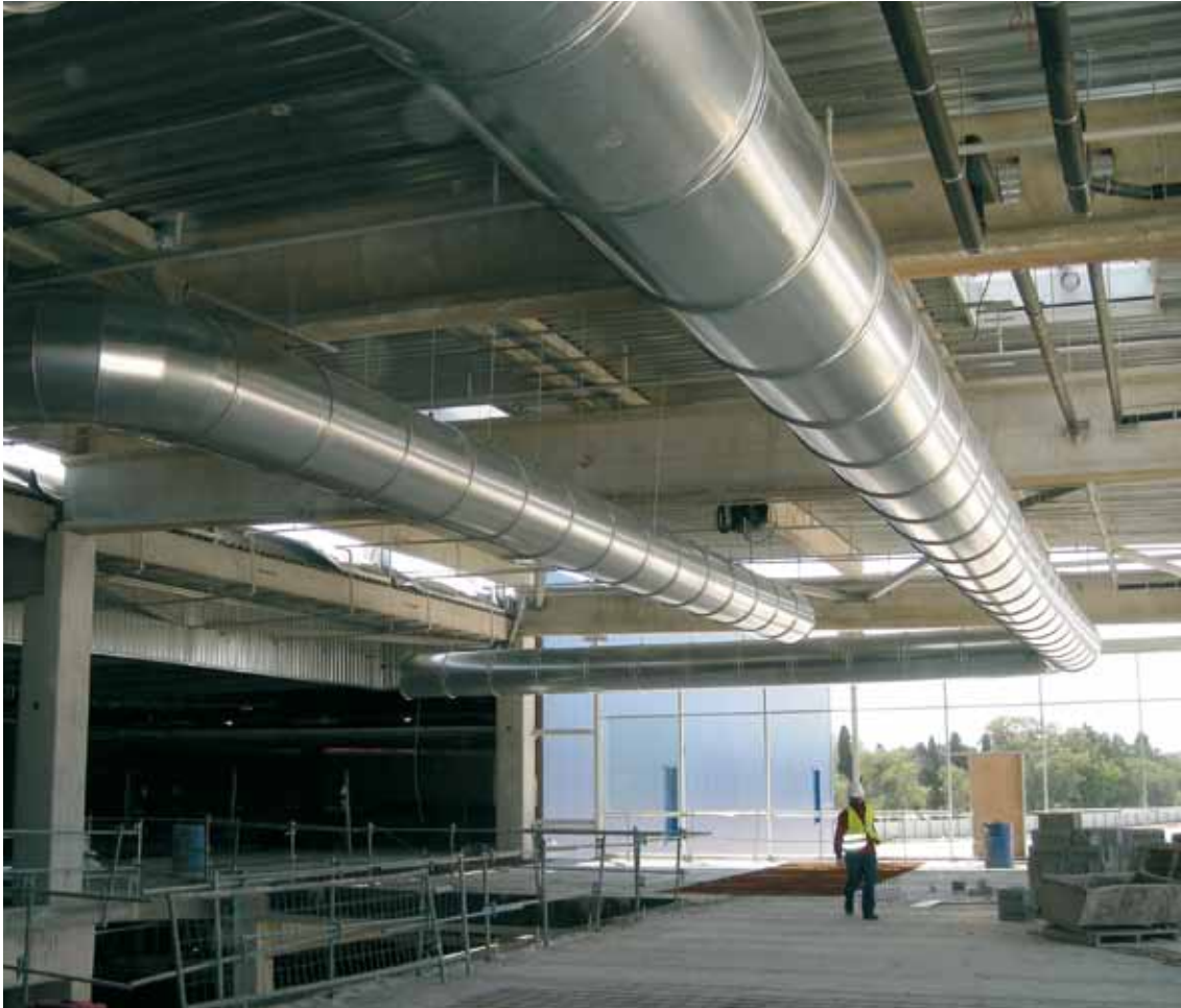
Canale circolare in metallo. Magazzino mobili. Circular metal duct. Furniture warehouse.
