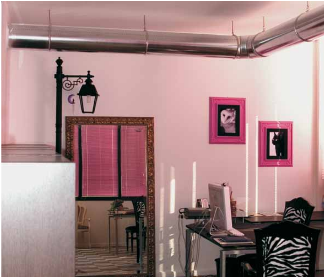
Canale circolare in metallo. Uffici. Circular metal duct. Office.
