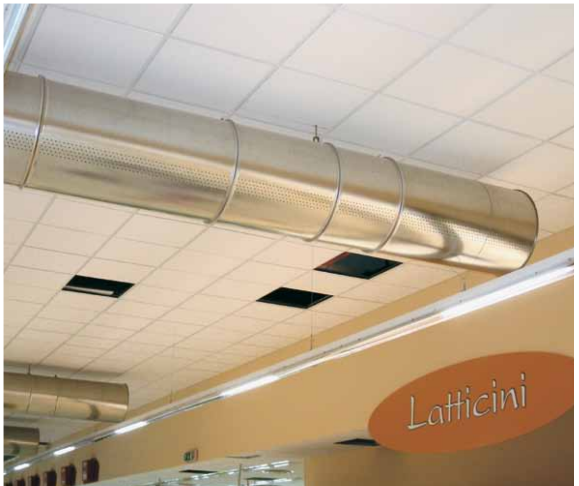
Canale circolare in metallo. Supermercato. Circular metal duct. Supermarket.
