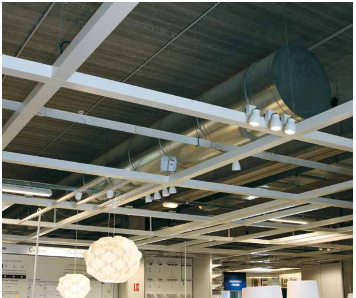
Canale circolare in metallo. Negozio mobili. Circular metal duct. Furniture shop.
