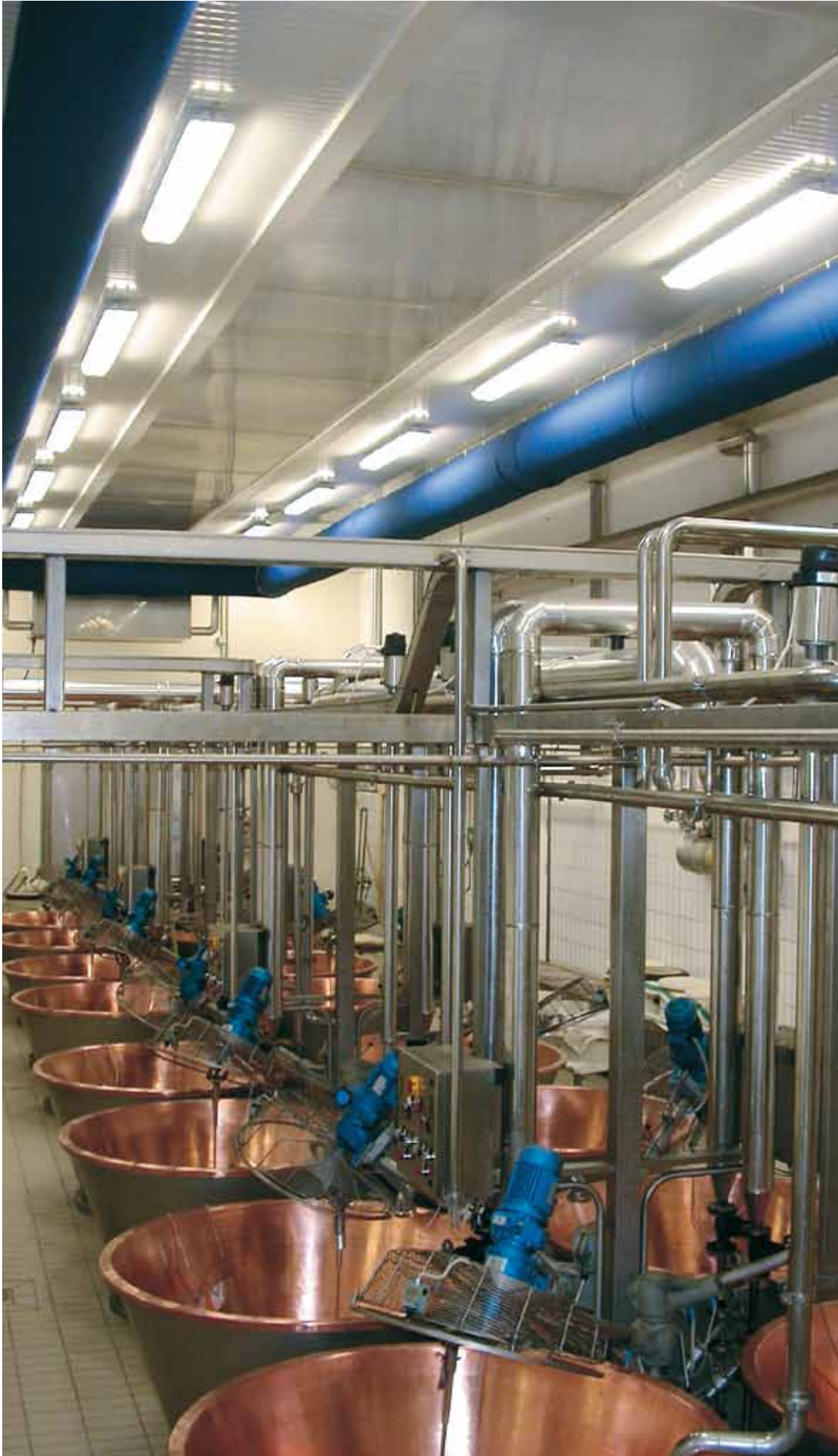
Canale circolare in tessuto. Sale lavorazione alimenti.
