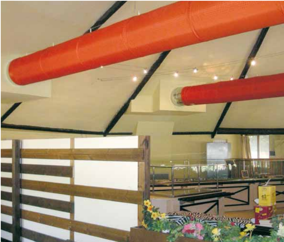
Canale circolare in tessuto. Ristorante. Circular textile duct. Restaurant.
