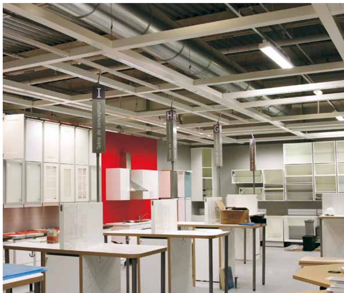
Canale circolare in metallo. Negozio mobili.
