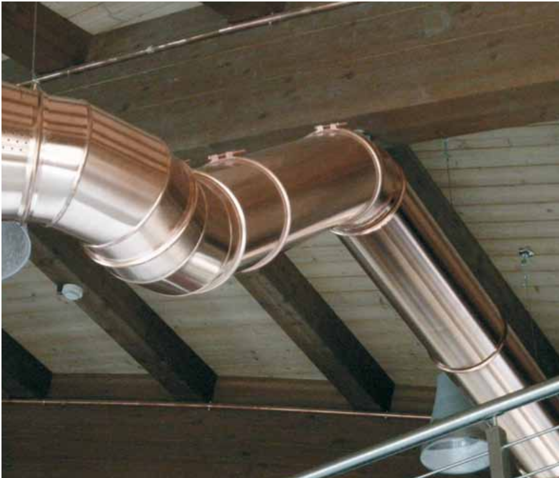
Canale circolare in metallo. Centro associativo. Circular metal duct. Association center.
